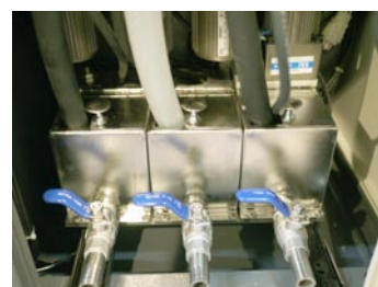
ケミカル、洗浄タンク
